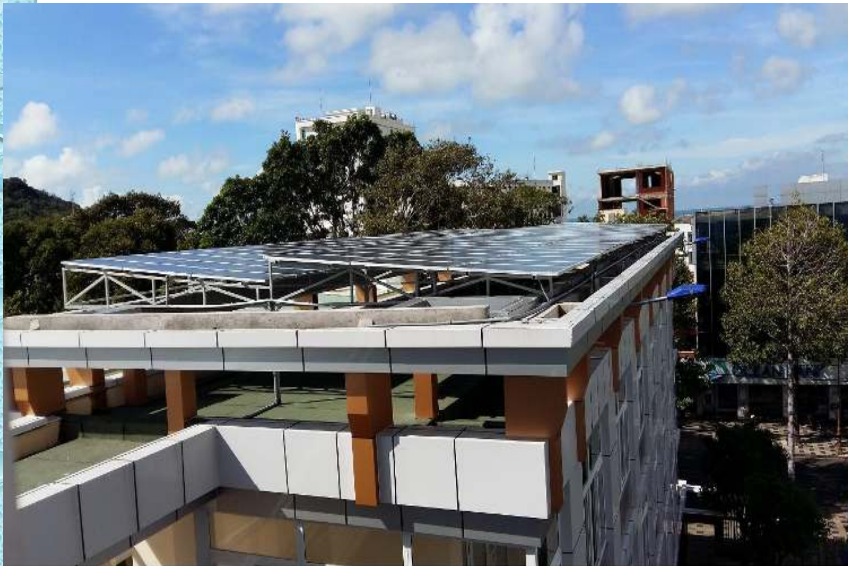
Hình 18. Hệ thống điện mặt trời lắp mái nổi lưới tại TP Vũng Tàu
