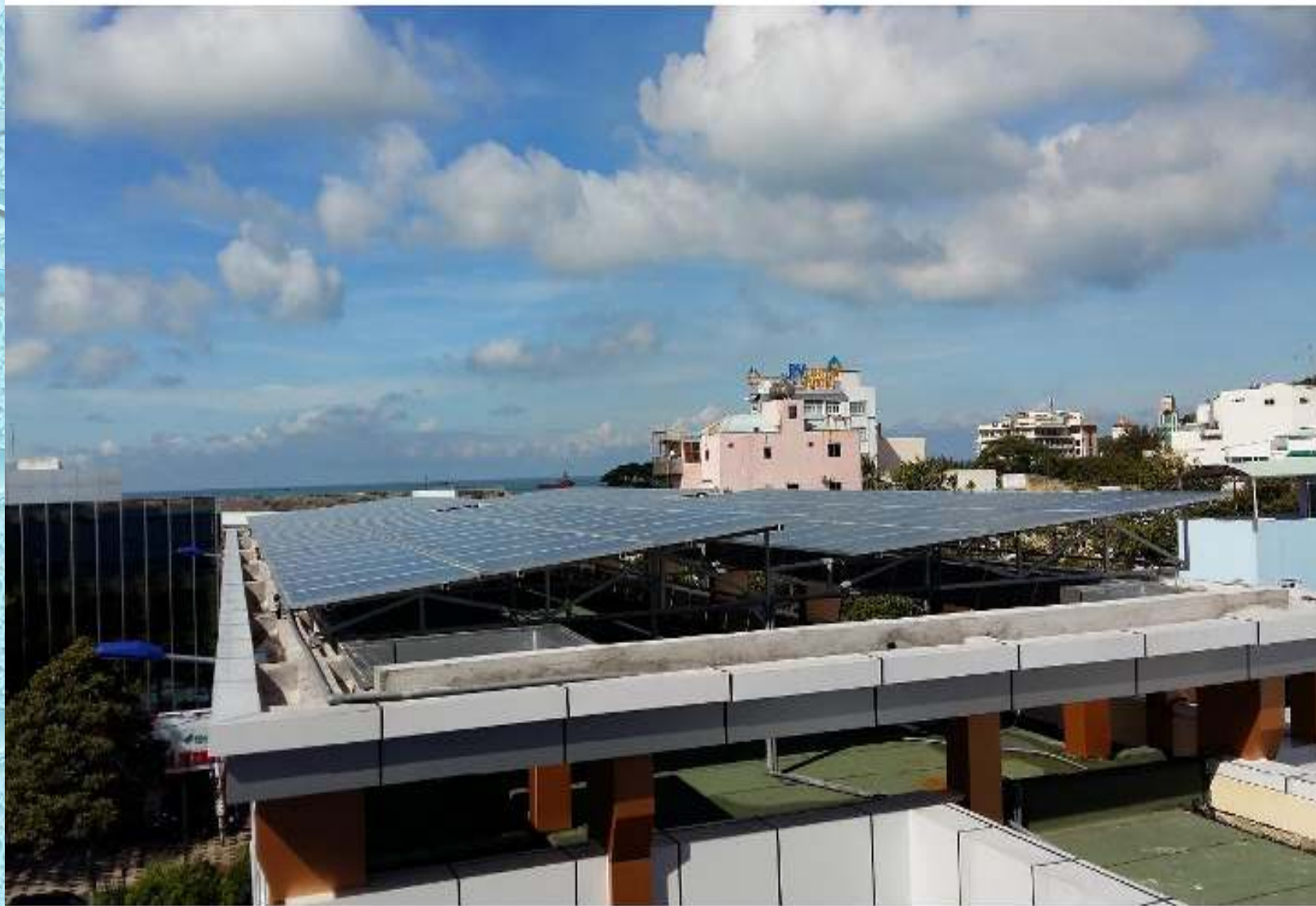
Hình 17. Hệ thống điện mặt trời lắp mái nổi lưới tại TP Vũng Tàu
